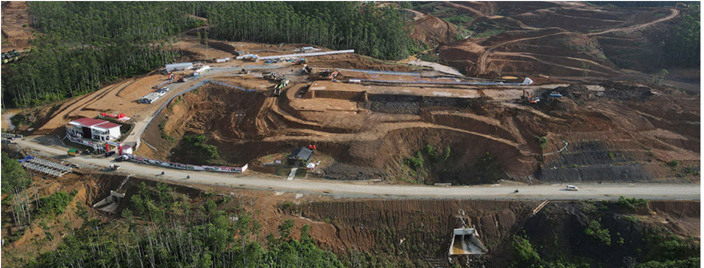
Suasana proyek pembangunan di Kawasan Inti Pusat Pemerintahan (KIPP) Ibu Kota Negara (IKN) Nusantara, Kabupaten Penajam Paser Utara, Kalimantan Timur.
